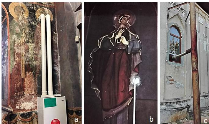
Fig. 9. Instalări inadecvate ale sistemelor de cădătură și/sau electricitate în monumente istorice a. Biserica Batistei (1763), București, monument istoric de interes național, b. Biserica Greacă, Constanța, cel mai vechi lăcalde cult din Constanța, c. Biserica Sfânta Treime (1800 -1850), Cilibiu, Golăești, Iași, monument istoric de interes local [Sursa foto: a http://tinyurl.com/j9t9tuq ; b, c. Arhivă personală, 2015]
