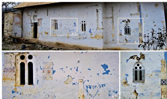
Fig. 10. Biserica Sf. Arhangheli (1495), din Cicău, Județul Alba: a, a.1, a.2. Detalii cu intervenții inadecvate și semne de vandalism [Sursa foto: Munteanu Marius, 2016]
