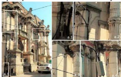
Fig. 20. Casa cu lei (1898), Constanța: a, b, c, d. Detalii cu cabluri montate de la diferiți furnizori de servicii [Sursa foto: Arhivă personală, 2015]
